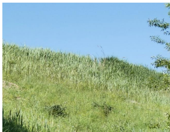
Riet in talud van A50
