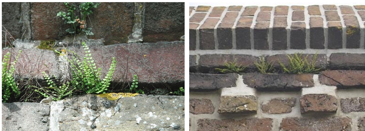
Steenbreekvaren op de kloostermuur vóór en na de renovatie in 2009
