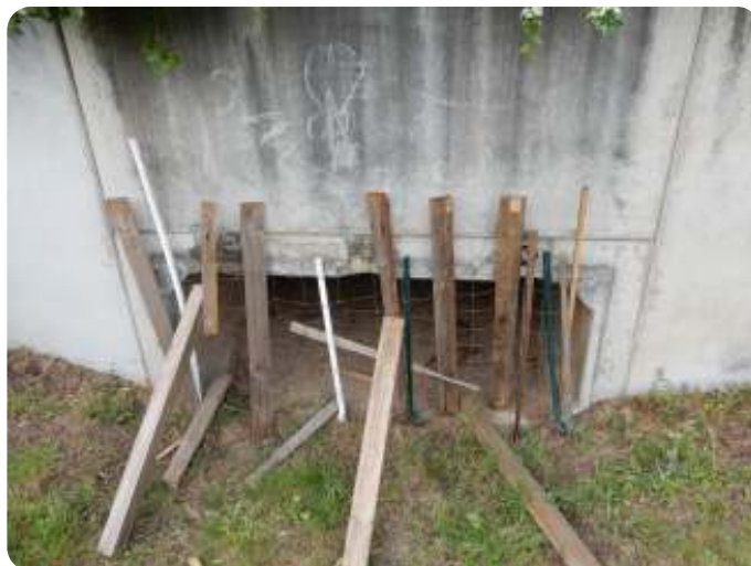
Faunatunnel tussen Roermond en Melick, foto Huug Stam
