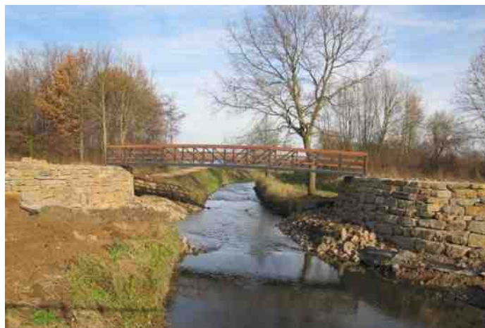
Deze brug over de Geleenbeek werd door Corio Glana in week 46 gelegd
