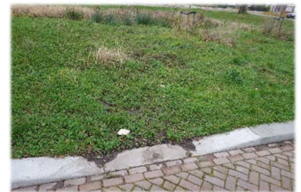
Verlaagde banden zorgen dat het water eenvoudig naar de wadi stroomt
