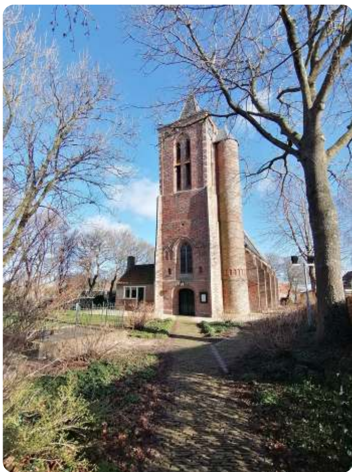
Overhellende toren van de kerk in Ritthem
