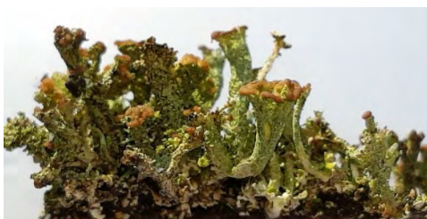
Korstmos van het dak
