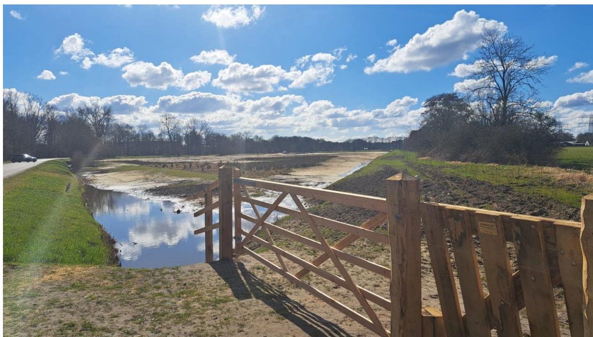
Het nieuwe natuurgebied langs de A.P Hilhorstweg in Soest, de Melksteeg, is volop in aanleg. Vorig jaar is het noordelijkste deel tot aan de Eem gereedgekomen, nu wordt er volop gewerkt aan het zuidelijke deel. Foto PvD
