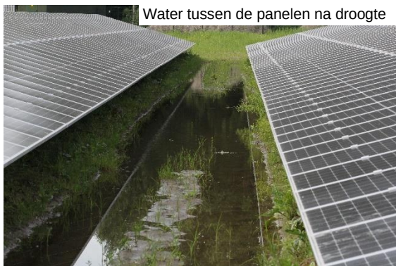
Water tussen de panelen na droogte
