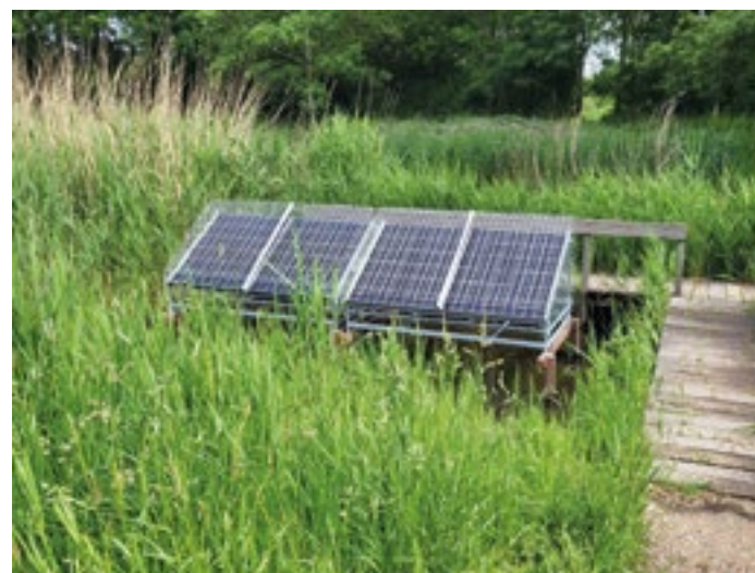
Zonnepanelen van de waterpomp
