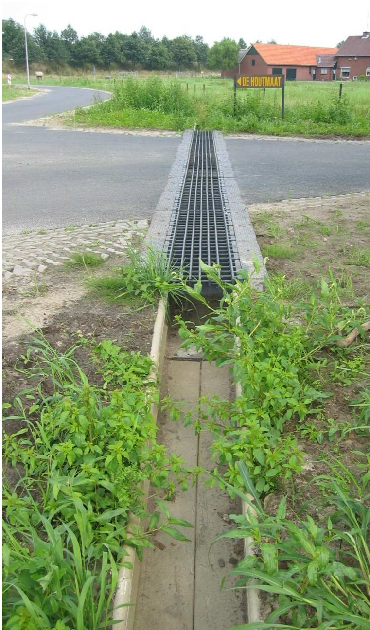
Paddentunnel met geleiding Dijksweg
